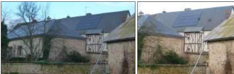
Panneaux photovoltaïques installés sur une construction du bourg
